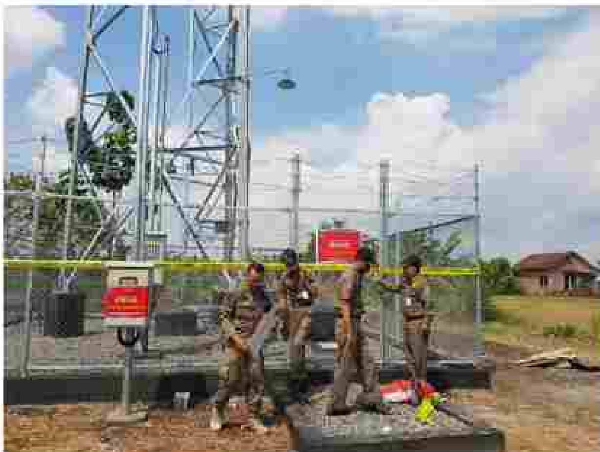
Pelanggaran Perda No. 14 Tahun 2015 (IMB)
